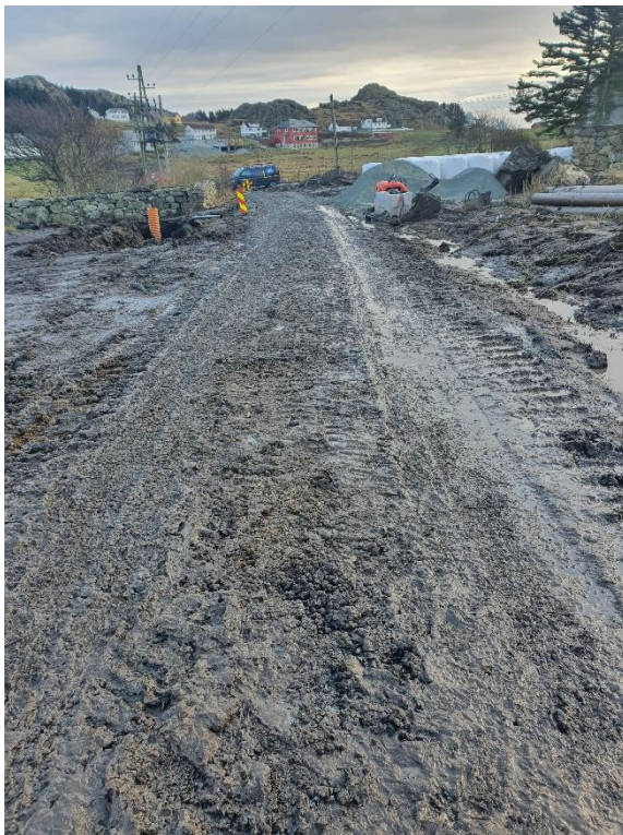
Veilegeme til renseanlegget har fått hard medfart i perioden nov2019 til feb. 2020 og skal reasfalteres 100 meter oppover fra Kvalvikvegen
