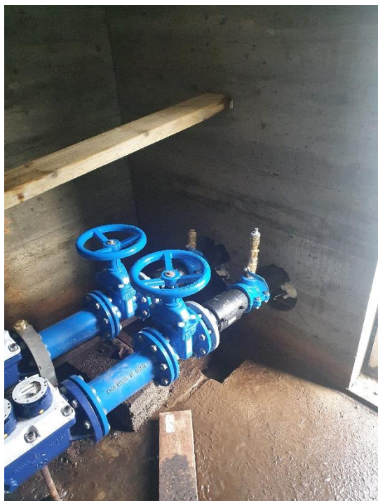
Vanntilførsel til Nordvik til venstre og Sørvik til høyre. Vannmålere i forkant.
