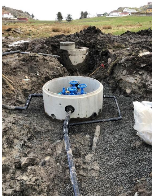
Ny fordelingskum, der vannledning til venstre går opp til Myre og ledning til høyre går til Siratun
