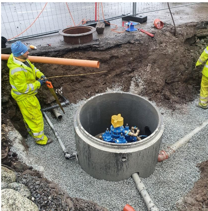
Ny fordelingskum på plass i Nordvågen klargjort til nybygg for Haugaland Kraft
